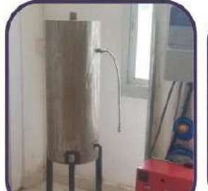
Chaudière à Fuel
