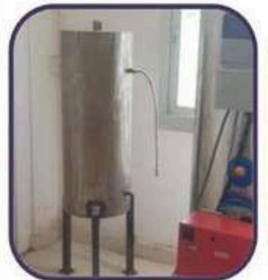
Chaudière à Fuel
