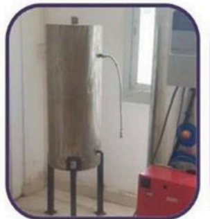
Chaudière à Fuel
